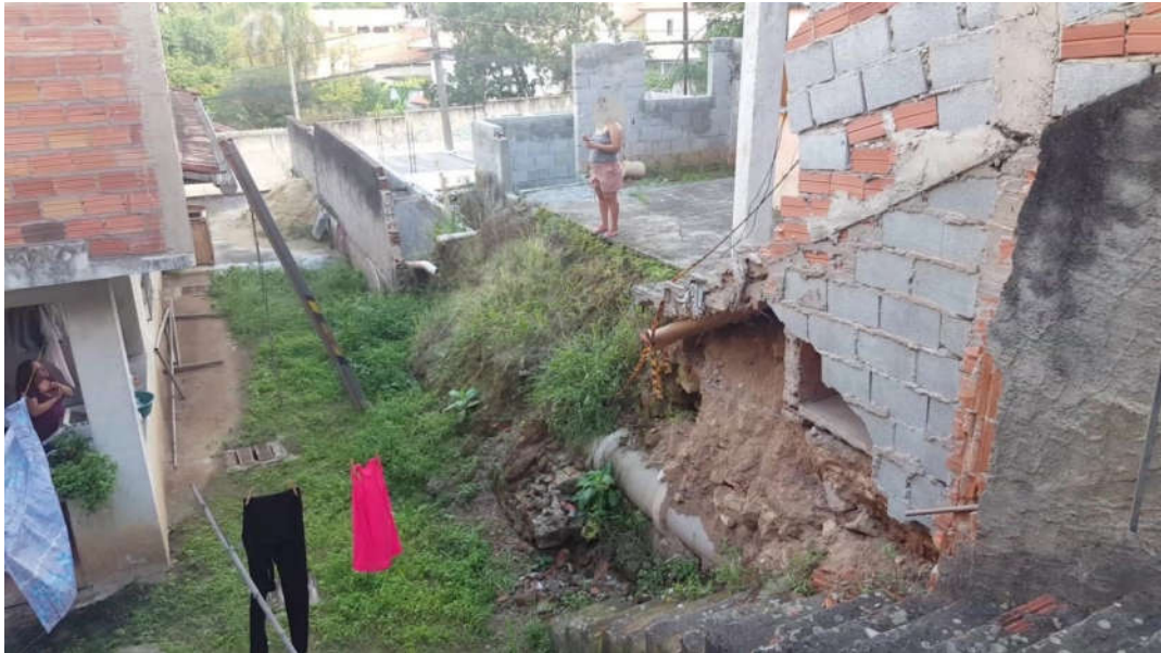
FIGURA 1 – MURO DE DIVISA - FOTO DE 21/03/2018
